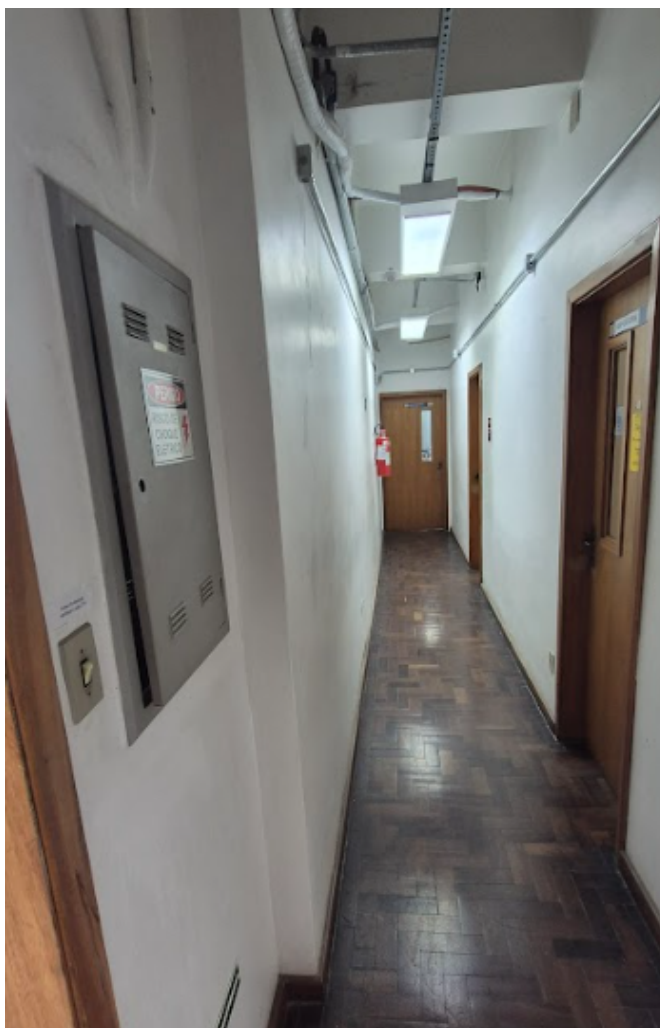
Figura 13 localização do quadro existente a ser reformado (retrofit)
