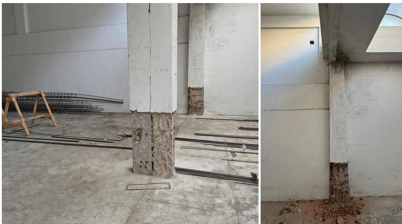
Figura 6 - Junta de movimentação não identificada em projeto, segundo pavimento (fonte: acervo da UFCSPA)
