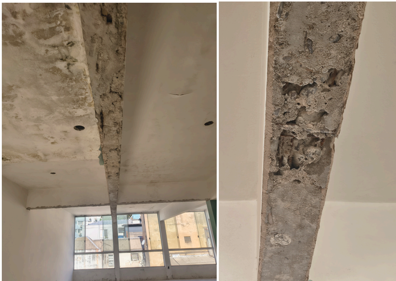
Figura 9 - Vigas com armaduras e cobrimentos comprometidos, quarto pavimento (fonte: acervo da UFCSPA)
