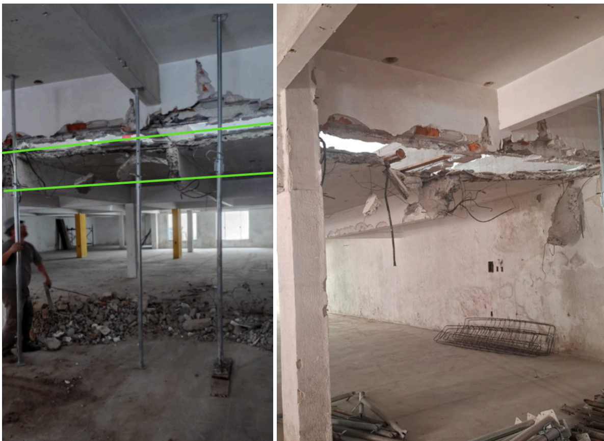
Figura 4 - Inexistência de viga em mudança de nível (fonte: acervo da UFCSPA)
