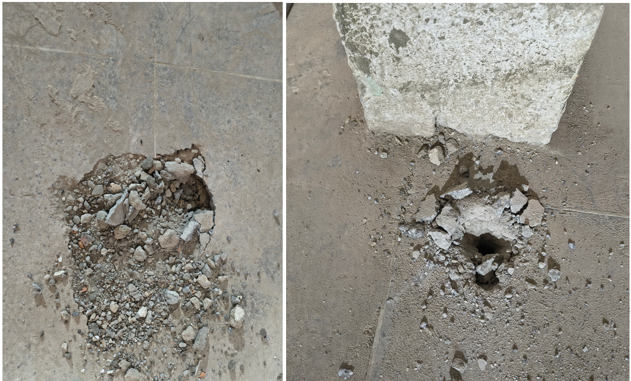
Figura 5 - Contrapiso sem capacidade de suporte, pavimento térreo (fonte: acervo da UFCSPA)
