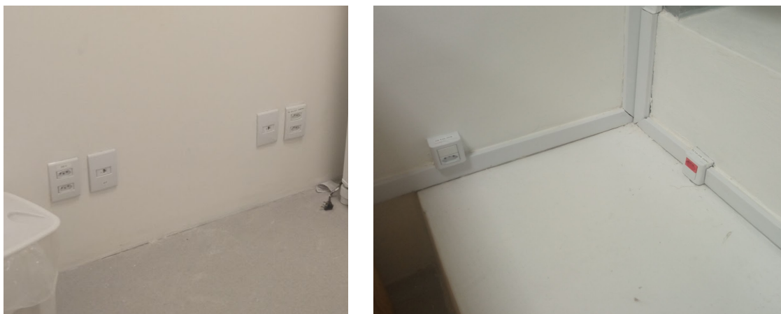
Figura 8 - Instalação/identificação de tomadas elétricas
