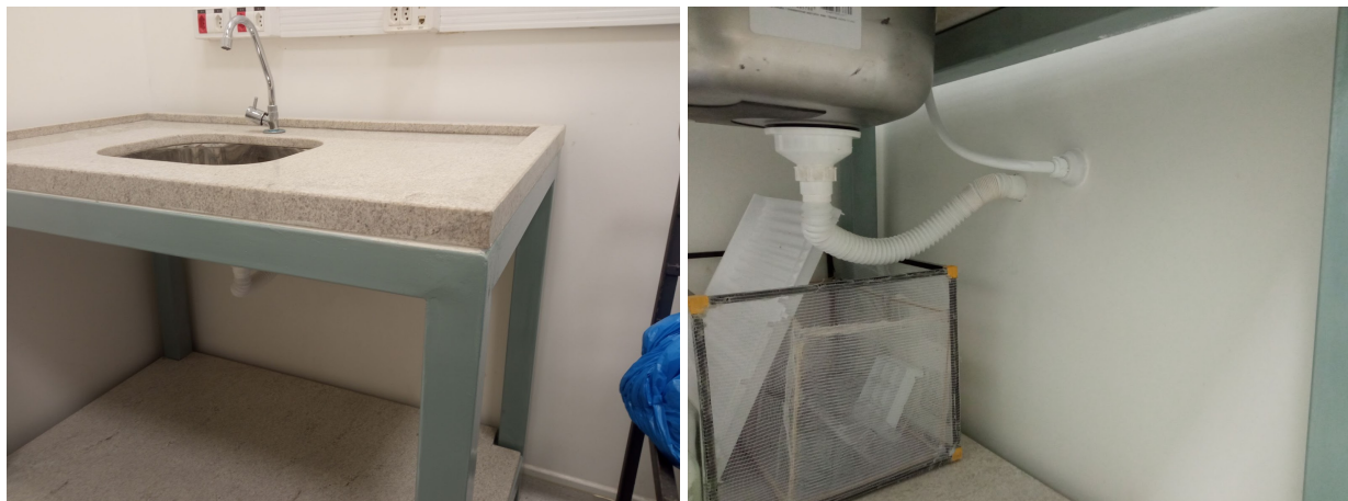
Figura 15 - Pia em metalon, com dois tampos em granito, cuba, torneira e sifão
