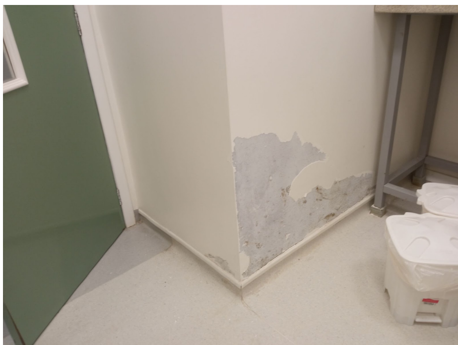
Figura 23 - Dano a parede da Sala 104B, 3 dias após o incidente de 16/08/2024.
