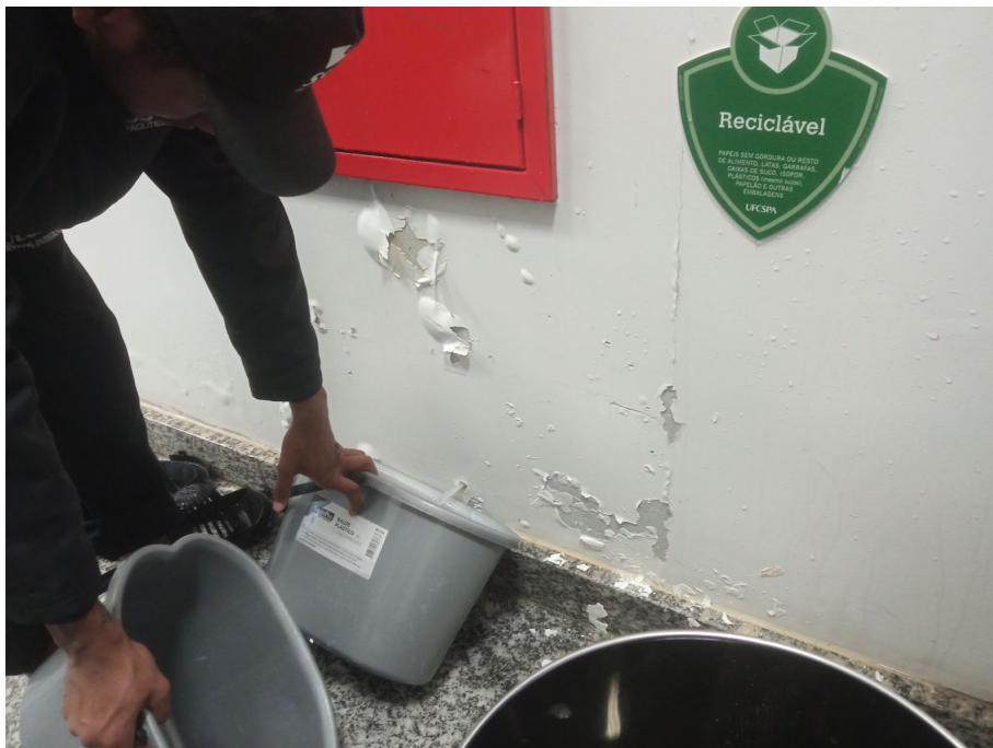
Figura 21 - Vazamento e danos ao revestimento da parede de água no incidente de 16/08/2024.
