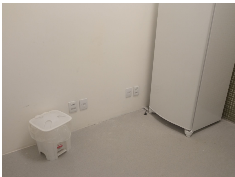
Figura 12 - pontos de tomada elétrica e de lógica
