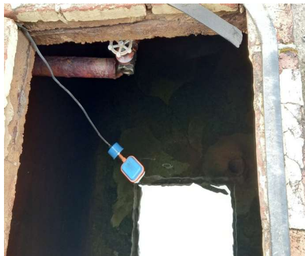
Imagem 13 – Tubulação do hidrante rompida e oxidada.
