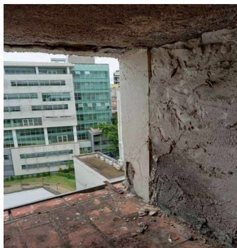
Imagem 09 – Pilar com deslocamento do concreto e fissuras.
