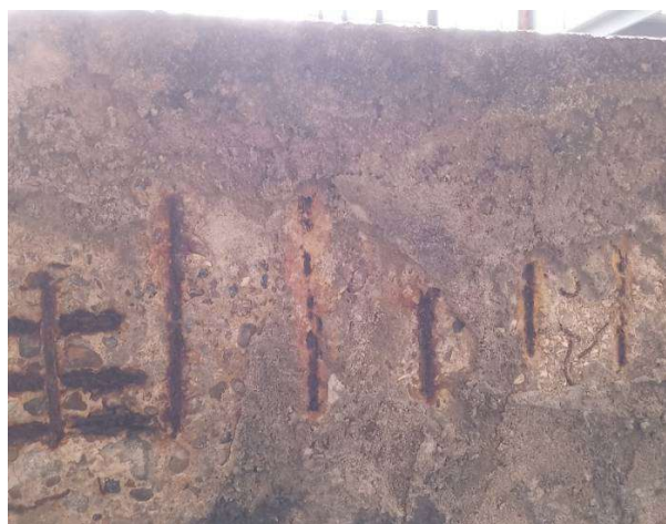
Imagem 08 – Armadura exposta e oxidada.
