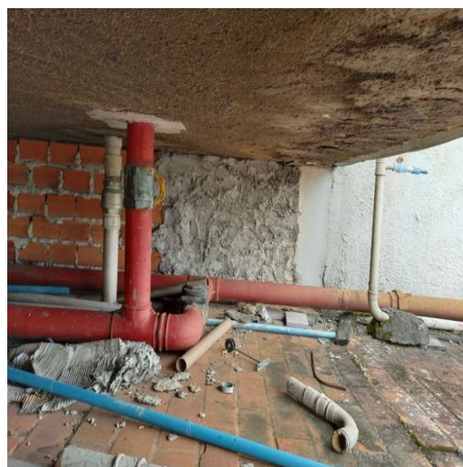
Imagem 05 – Tubulação hidrante e ladrão.
