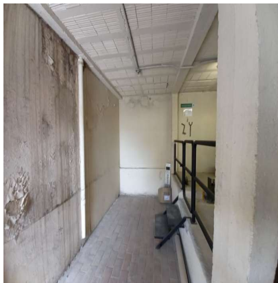
Imagem 12 – Parede da casa de máquinas com infiltração.
