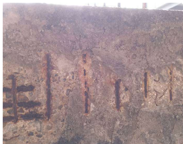
Imagem 08 – Armadura exposta e oxidada.
