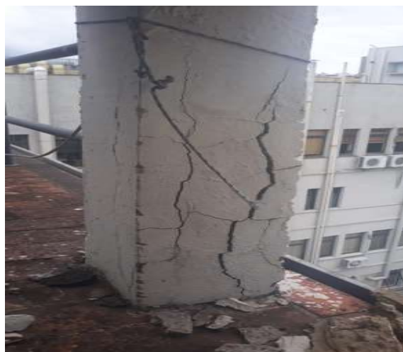
Imagem 11 – Pilar com trintas e rachaduras.
