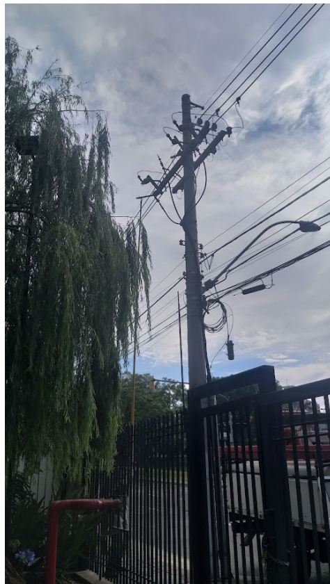
Foto 15 – Desligamento da energia pela concessionária.
