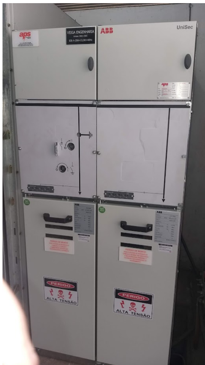
Foto 21 – Módulos de entrada e aterramento.
