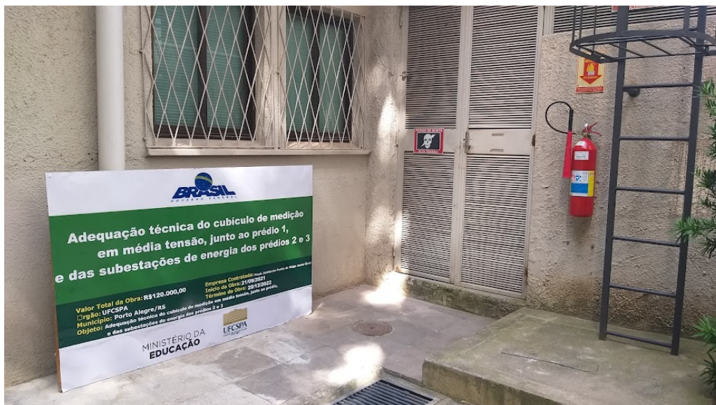
Foto 01 – Placa de identificação dos serviços.
