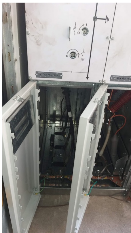
Foto 20 – Módulos de entrada e aterramento.
