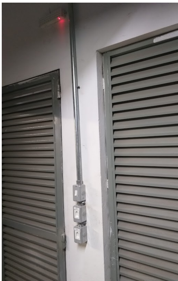
Foto 12 – Instalações em bt.
