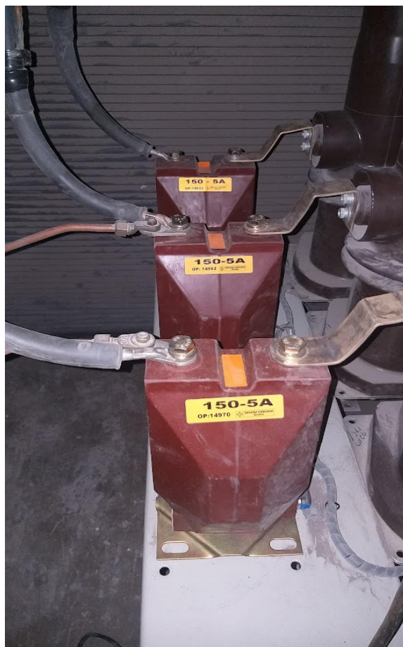
Foto 07 – Transformadores de corrente 150-5A.
