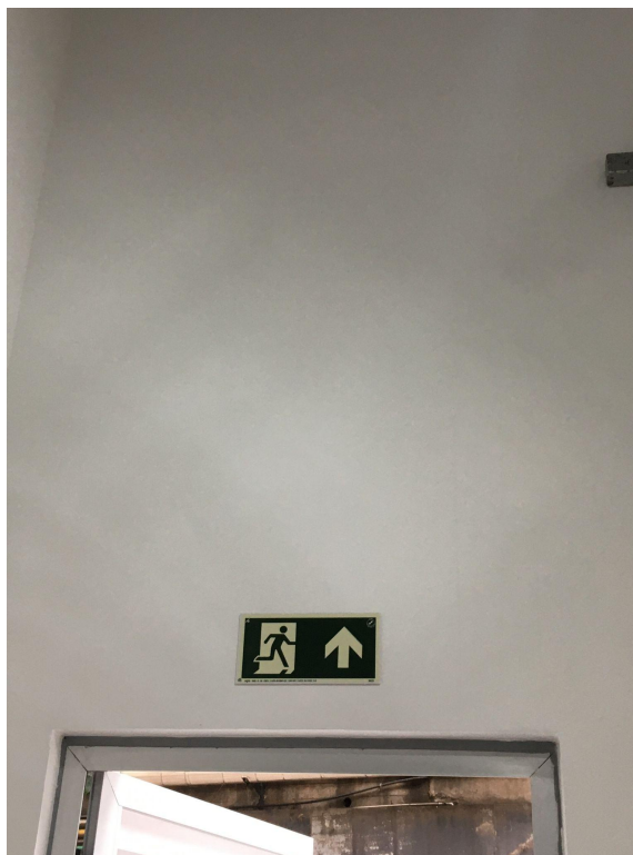
Foto 13 - Placas de sinalização de incêndio.
