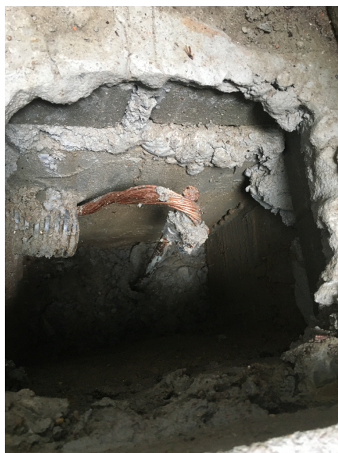
Foto 10 - Haste de aterramento para SPDA.
