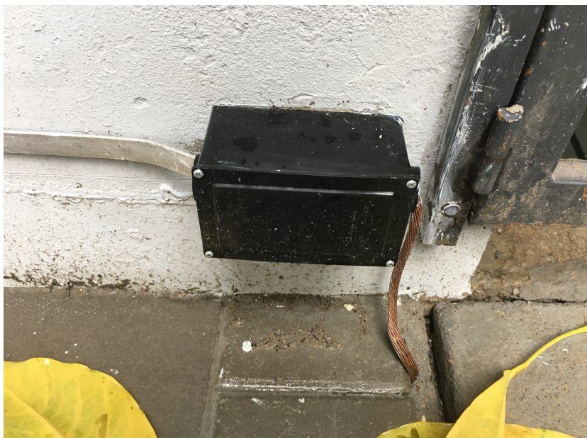
Foto 11 - Caixa de inspeção suspensa para SPDA.
