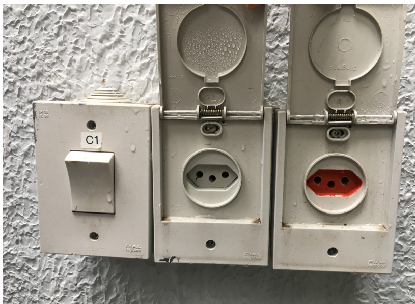
Foto 03 - Interruptor simples com módulo à prova d'água.
