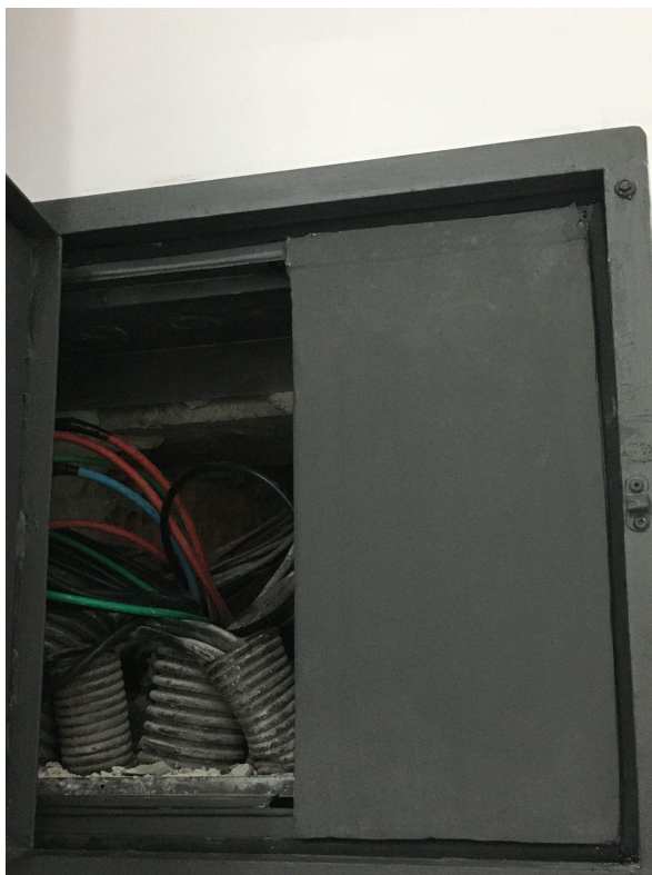
Foto 04 - Caixa de passagem de embutir.
