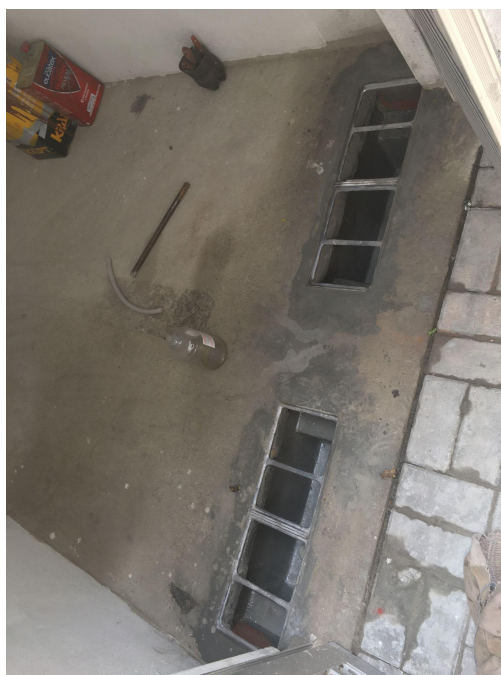
Foto 04 - Caixa de coleta de resíduos com tubulações para a casa de resíduos.
