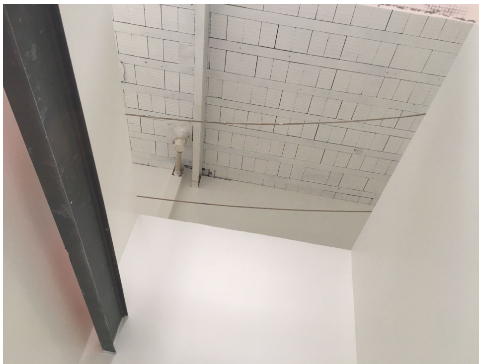
Foto 05 - Pintura acrílica em teto.
