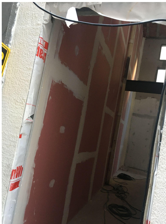
Foto 05 - Paredes em drywall resistente a fogo.
