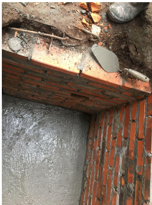
Foto 07 - Caixa de contenção de resíduos externa.
