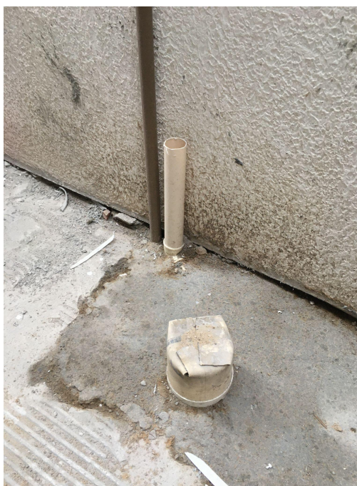
Foto 08 - Caixas sifonadas em PVC para esgoto.
