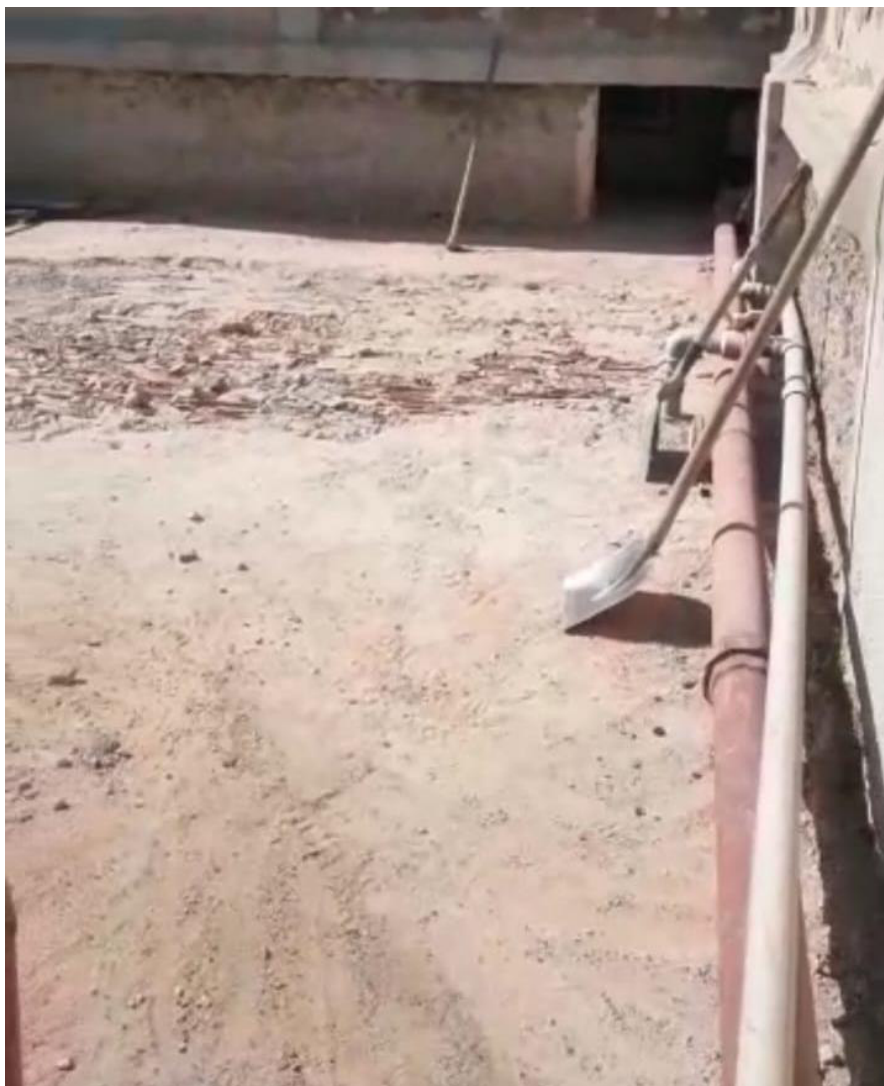
Foto 5 – Laje sem a proteção mecânica
