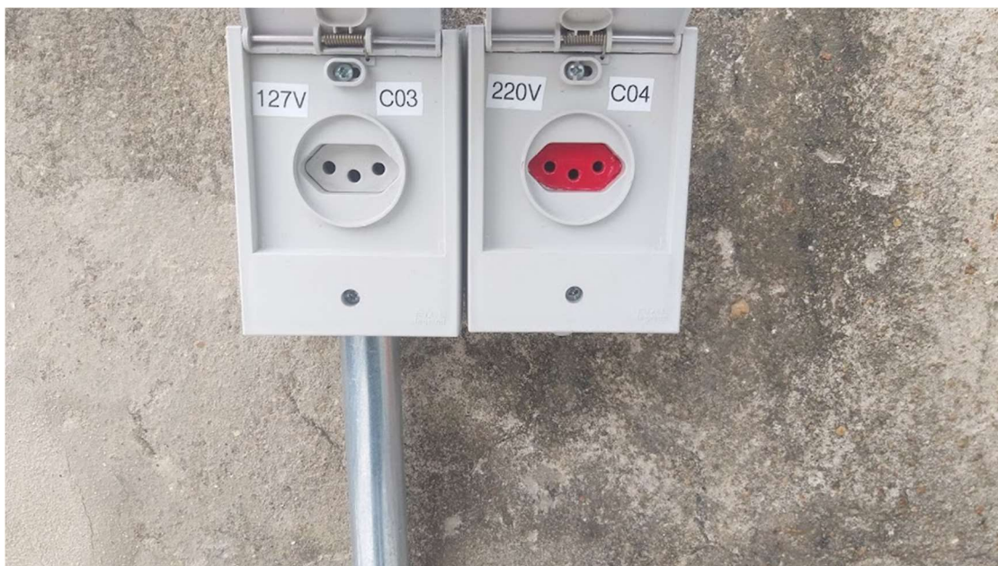
Foto 11 - Tomadas à prova d'água.
