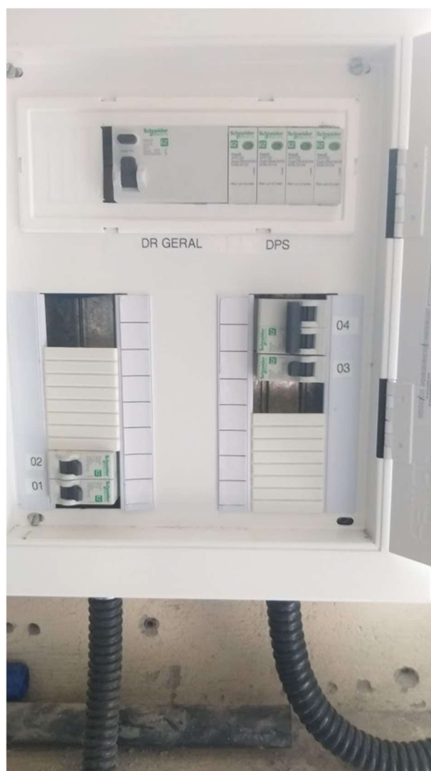
Foto 06 - Novo CD, incluindo disjuntores, DPS's e dispositivo DR.
