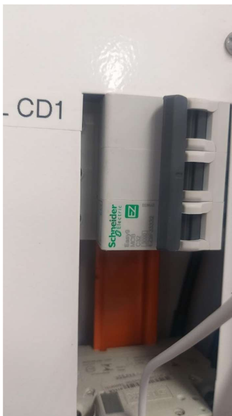
Foto 07 - Disjuntor tripolar 32A.
