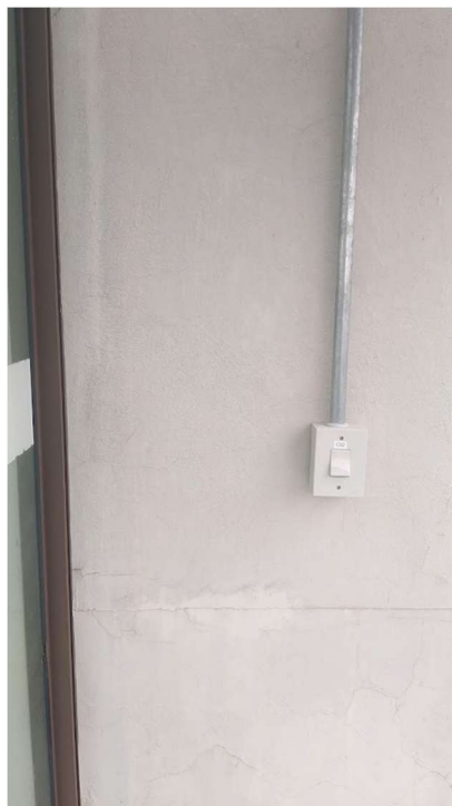
Foto 10 - Interruptor à prova d'água.
